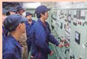
発電機並列運転操作
