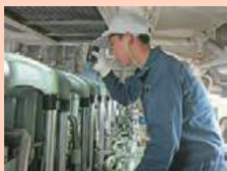
機関当直(主機確認)
