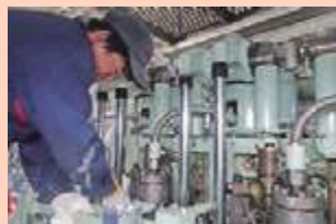
当直業務(主機状態確認)
