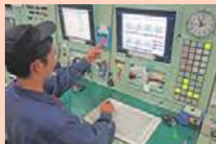
機器類状態監視・日誌記録
