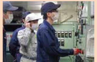
発電機並列運転操作
