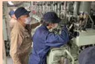
当直業務(主機状態確認)
