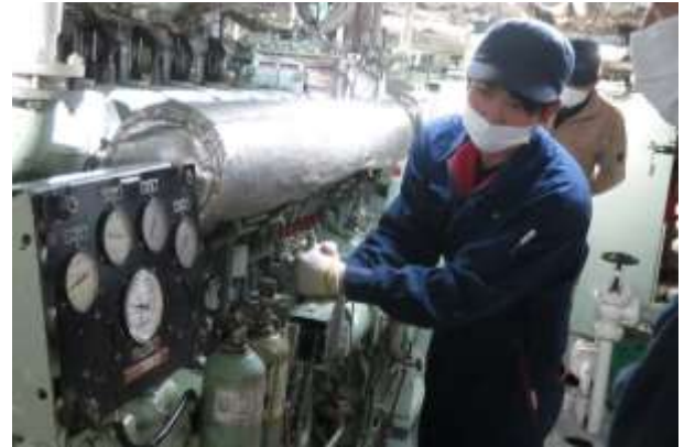
機関当直（発電機起動）
