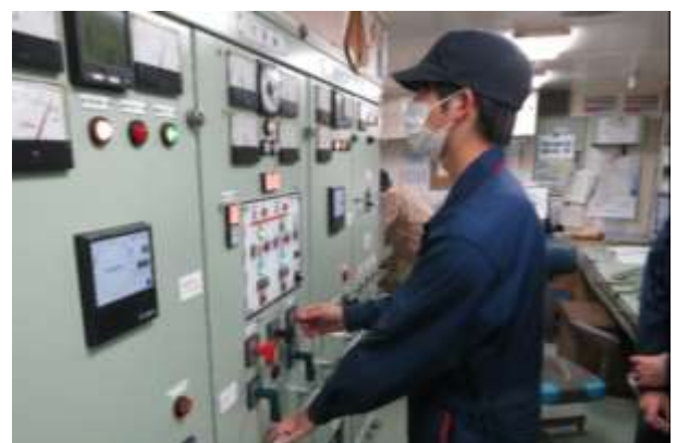
機関当直（配電盤操作）
