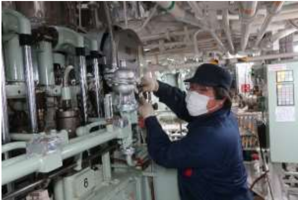
機関当直（主機起動）
