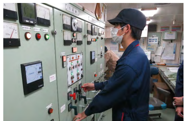
機関当直（配電盤操作）
