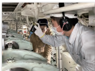
機関当直(運転状態の点検)
