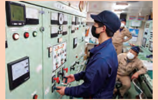
発電機並列運転操作
